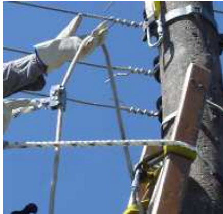
Figura 18 - Transposição da linha de vida para novo ponto de ancoragem
