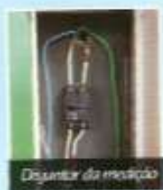
Disjuntor da residência
